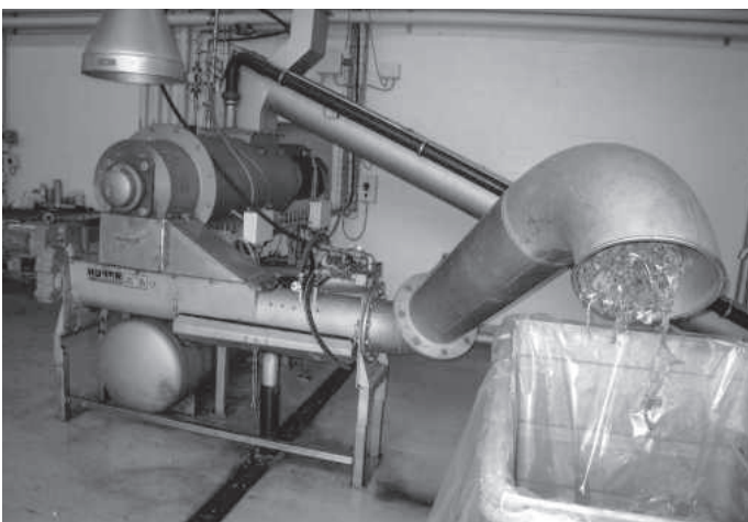
Le broyeur à marteaux réduit en miettes des déchets biogènes pour permettre leur revalorisation ultérieure.
